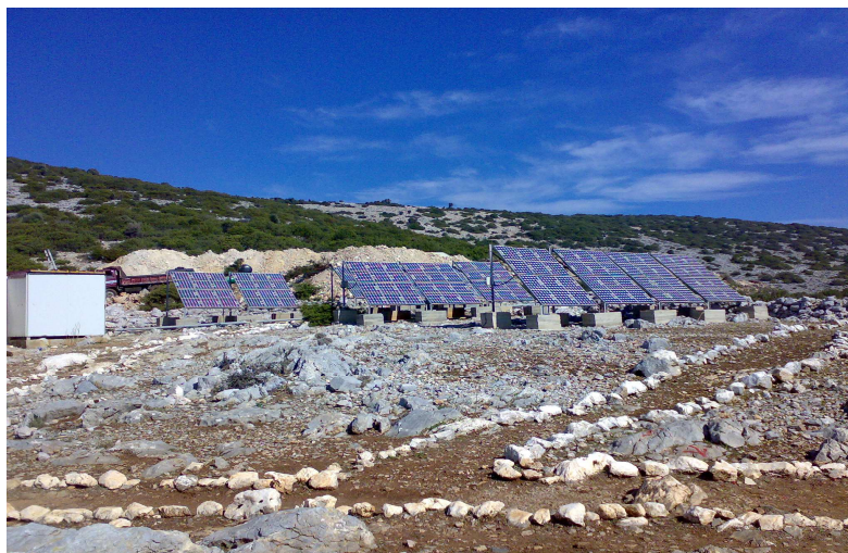
Εικόνα 5. Αποψη των φωτοβολταϊκών πλαισίων που εγκαταστάθηκαν στην Καλόλιμνο
