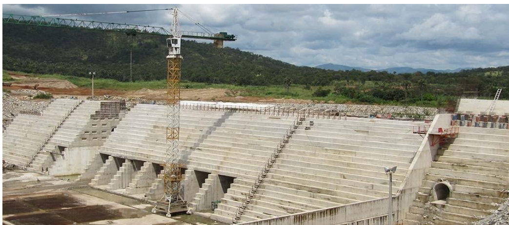
Εικόνα 11: Το υδροηλεκτρικό εργοστάσιο Mambila στη Νιγηρία
