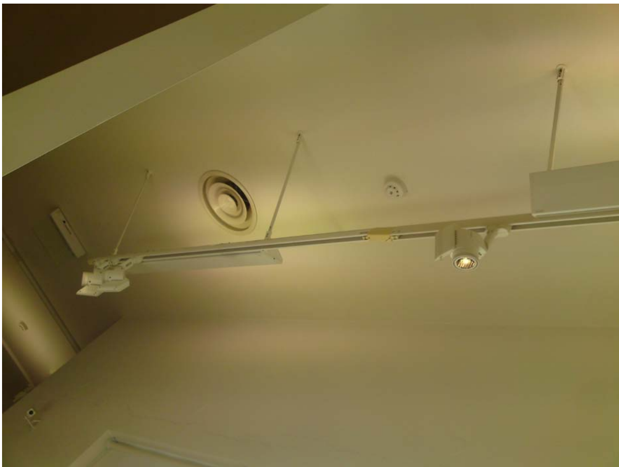
Φωτογραφία 8 : Αερισμός, αυτόματο σύστημα πυρανίχνευσης και φωτισμός σποτ.
