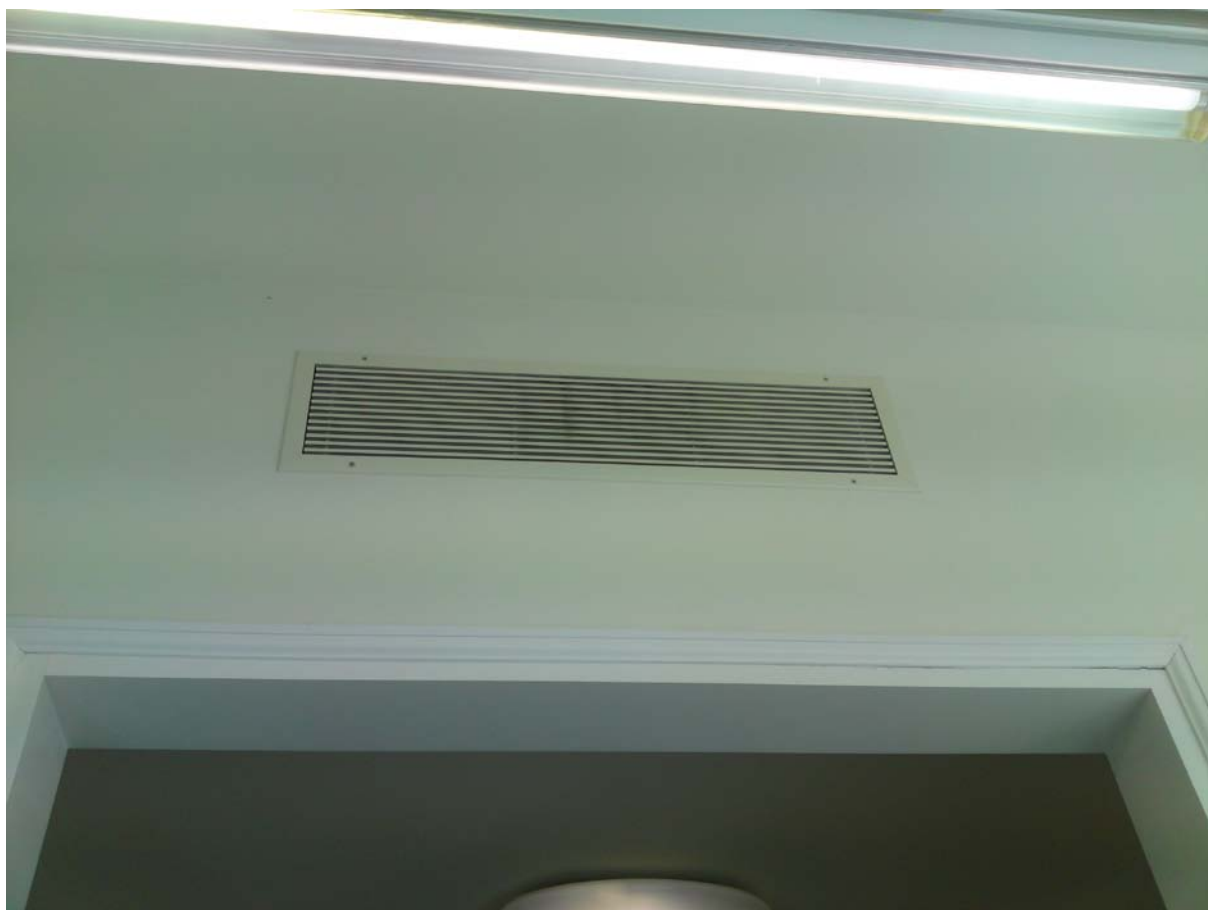
Φωτογραφία 20 : Λεπτομέρεια αεραγωγού ψύξης – θέρμανσης.
