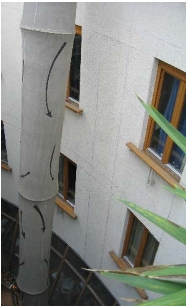
Εικόνα 2 : Το αίθριο του «Πράσινου Κτιρίου» με λεπτομέρεια του αγωγού αερισμού
