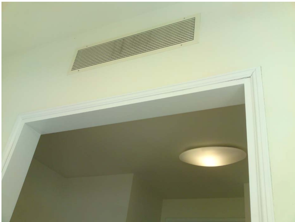
Φωτογραφία 21 : Λεπτομέρεια αεραγωγού ψύξης – θέρμανσης.
