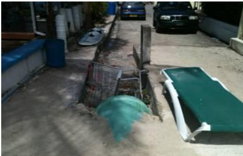
Φωτογραφία 25 Αγωγός Όμβριων Υδάτων 896
