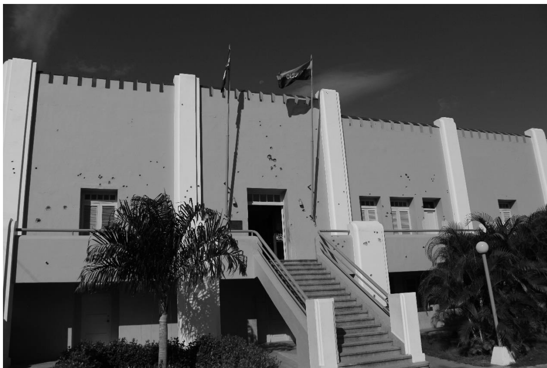
Φωτογραφία 1. Στρατώνες Μονκάδα. Οι σφαίρες έχουν αφήσει, εμφανώς μέχρι σήμερα, τα σημάδια τους στον τοίχο του στρατώνα. Φωτογραφία: Του ιδίου
