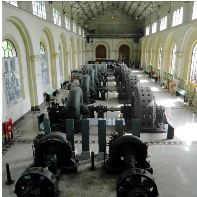
Εικόνα 22: Ο σταθμός υδροηλεκτρικής ενέργειας “Antonio Pitter” εσωτερικά.
