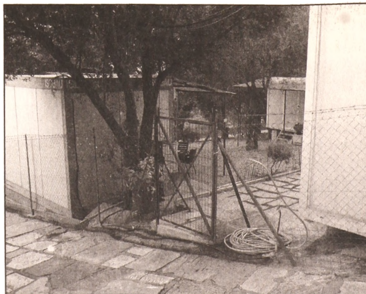
Οι επεμβάσεις με σιδηροκατασκευές έχουν αλλοιώσει τον χαρακτήρα του περιπτέρου του Πικιώνη.
