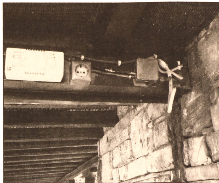
Αριστερά, η μοκέτα που βυζαίνει στο χώμα. Δεξιά, «λεπτομέρεια» από τις ηλεκτρικές εγκαταστάσεις
