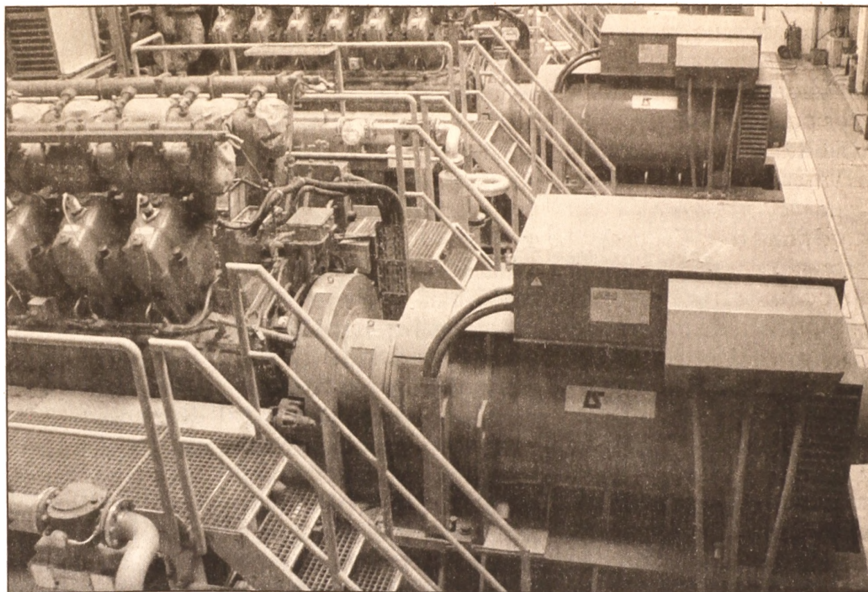
Μονάδα συμπαραγωγής ηλεκτρικής και θερμικής ενέργειας, ηλεκτρικής ισχύος 7,14 MW και 10,35 MW ωφέλιμης θερμότητας, από καύση βιοαερίου παραγόμενου στο Κ.Ε.Λ. Ψυττάλειας (2003).
