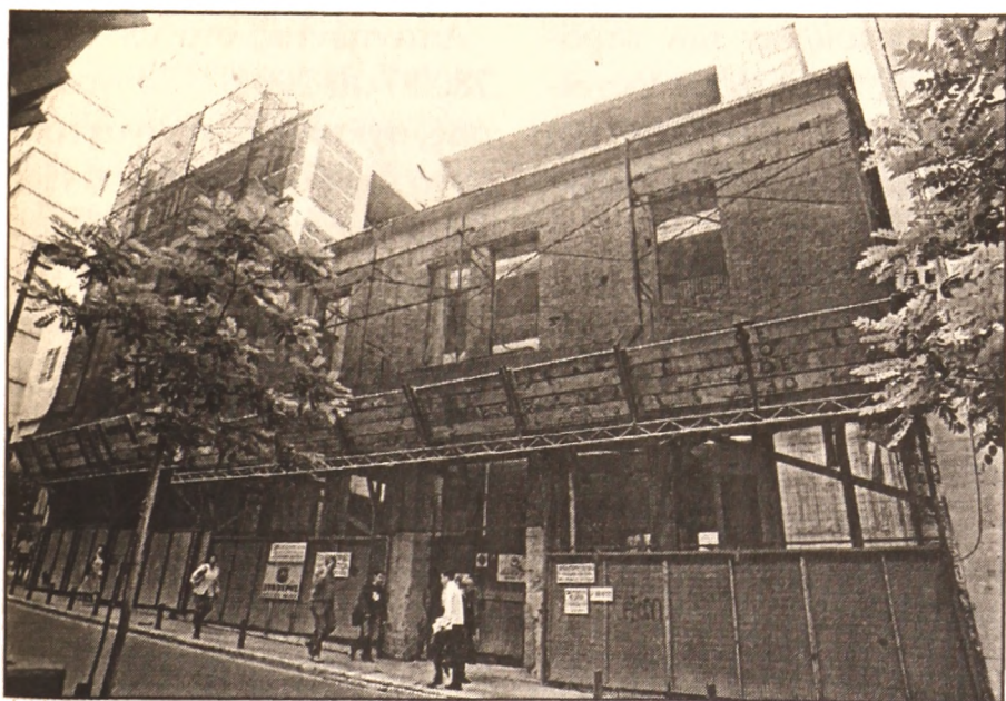
Μητροπόλεως 21. ΦΕΚ 74/Δ/2004. Διαφαίνεται ήδη η προσθήκη ορόφου από την πίσω πλευρά του κτηρίου. Η «ανακατασκευή» έχει ήδη προχωρήσει.
