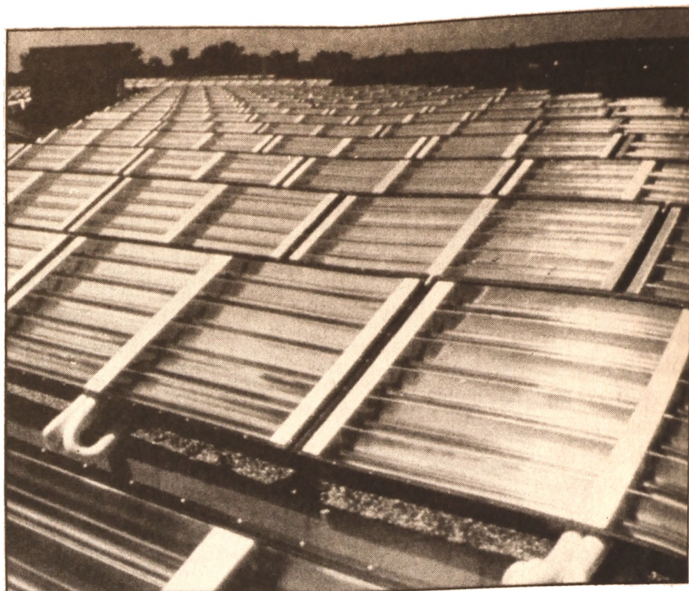
Σύνθετοι παραβολικοί συγκεντρωτές εγκατεστημένοι στο Ιλλινόις των ΗΠΑ. Κάθε ανακλαστήρας συγκεντρώνει την ηλιακή ακτινοβολία σε μια σωλήνα κενού που διατηρεί την θερμότητα με τρόπο ανάλογο με αυτόν του δοχείου θερμός.
