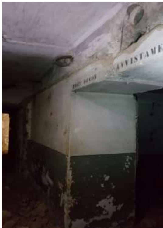
Εικόνα 17 – Εσωτερικό κέντρου ασυρμάτου, όρος Πατέλα
