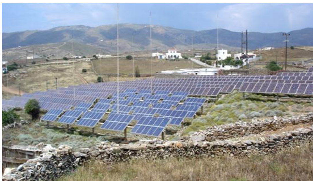
Εικόνα 3.4: Απεικόνιση του Φ/Β σταθμού της Κύθνου (Πηγή: ΔΕΗ ΑΝ)
